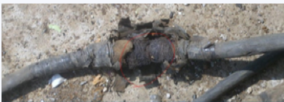
용접봉 홀더 연결 불량 및 케이블 파손
