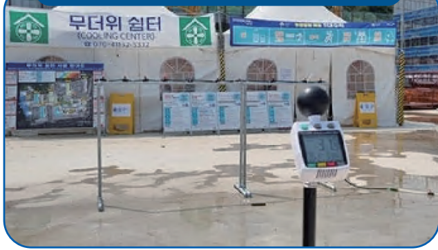
무더위 쉼터 및 체감온도 측정계 설치
