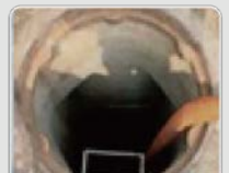
บ่อพักน้ำ
