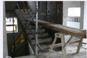
사진의 안전난간은 사고 후 설치된 것
