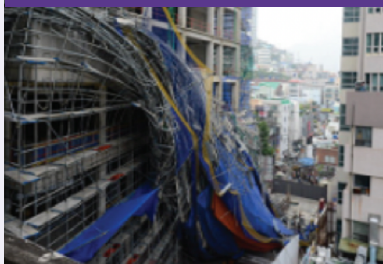
내부 작업 중 붕괴, 인명피해 없음
