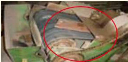
예) 컨베이어 드럼 및 체인 동력 전달부 덮개 미설치
