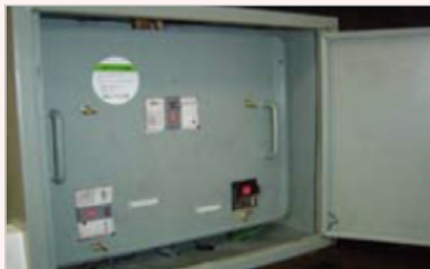
분전반 : "D"자형 손잡이 설치 예
