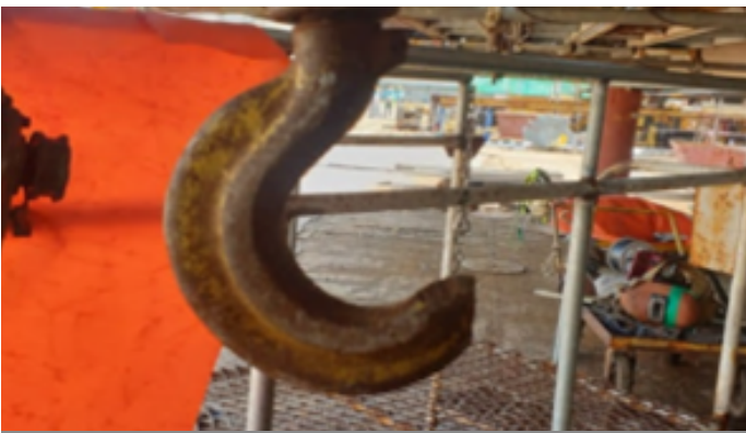
레버풀러 훅 손상(끝단 파손)
